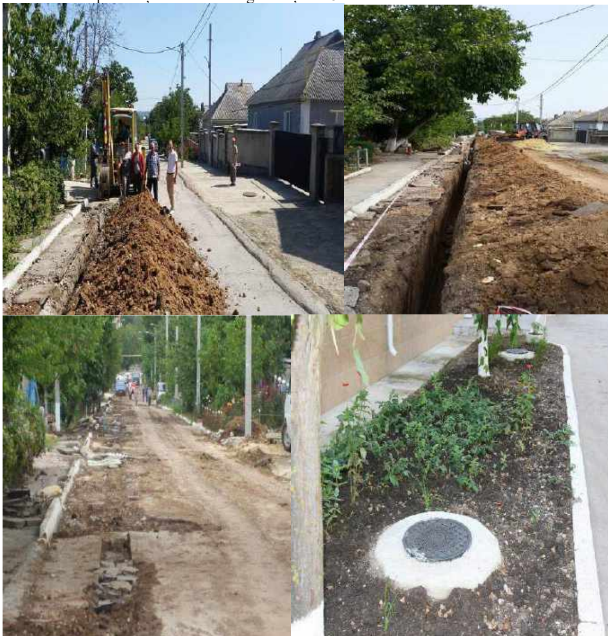
Anexa 6. Poze privind monitorizarea lucrărilor de reparație a sistemelor exterioare și interioare de apeduct și canalizare la grădinița nr. 5 din or. Rezina
